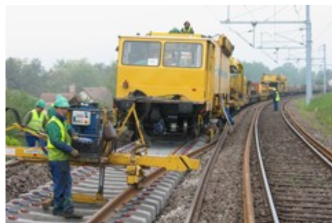
Longs Rails soudés sur traverses béton
